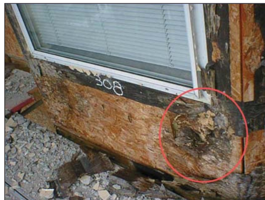
Figure 1. Dommage causé par les infiltrations d'eau
